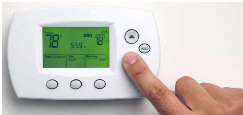
Gambar 30. Tersedia Pengontrol Suhu di Setiap Area Kerja
